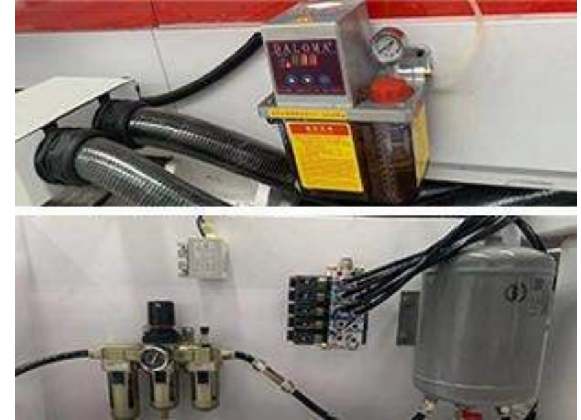
Hava basıncı depolama tankı, otomatik yağ doldurma pompası, buhar su ayırıcısı, hava basıncı alarmı
