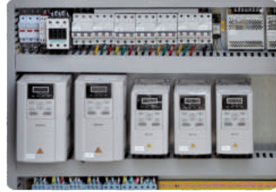
Elektrik kontrol düzeni
